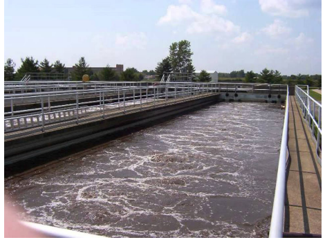
บ่อบำบัดน้ำเสีย
