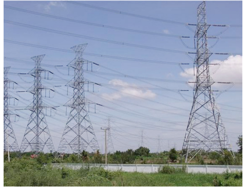
เสาไฟฟ้า
